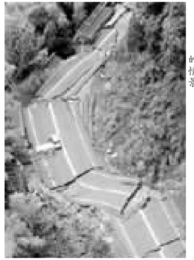
七月份，日本本州岛中北部城市长冈遭遇强烈地震，一条汽车高速公路崩塌后
